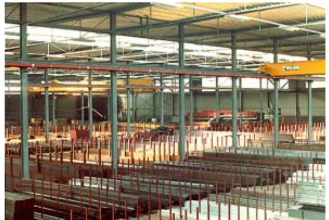
napojni i upravljački vodovi mosnih kranova
