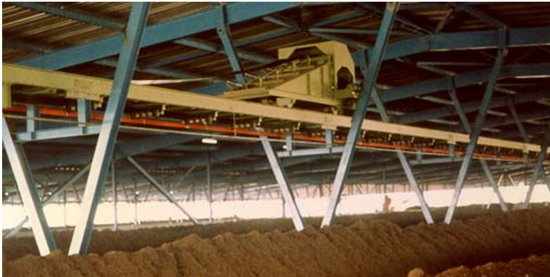
napojni i upravljački vodovi strojeva postrojenja za dobivanje umjetnog gnojiva
